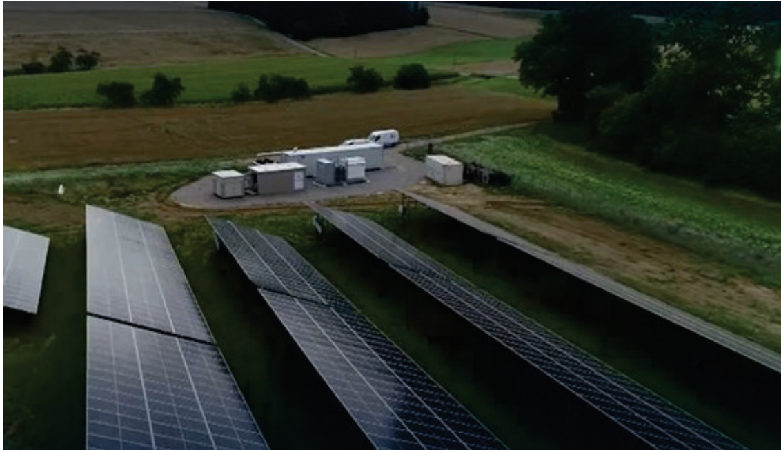
Abbildung 8: Beispiel für einen Speichercontainer angrenzend an eine PV-FFA; https://www.swr.de/swraktuell/baden-wuerttemberg/hybrid-solarpark-1930-100.html
